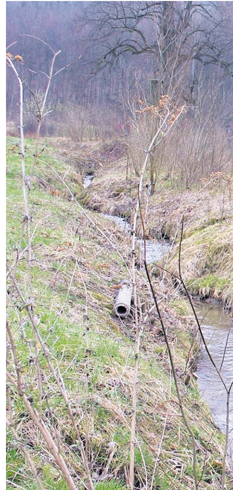
Der ausgedolte Heuelmülibach in Schafisheim
